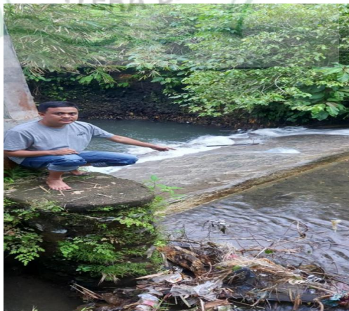
Gambar 4.2 Kondisi Tumpukan Sedimen pada STA 201+400
