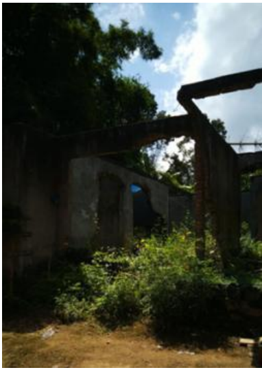
Gambar 3. Puing bangunan yang akan dijadikan kumbung jamur Tiram. (sumber foto pribadi)
