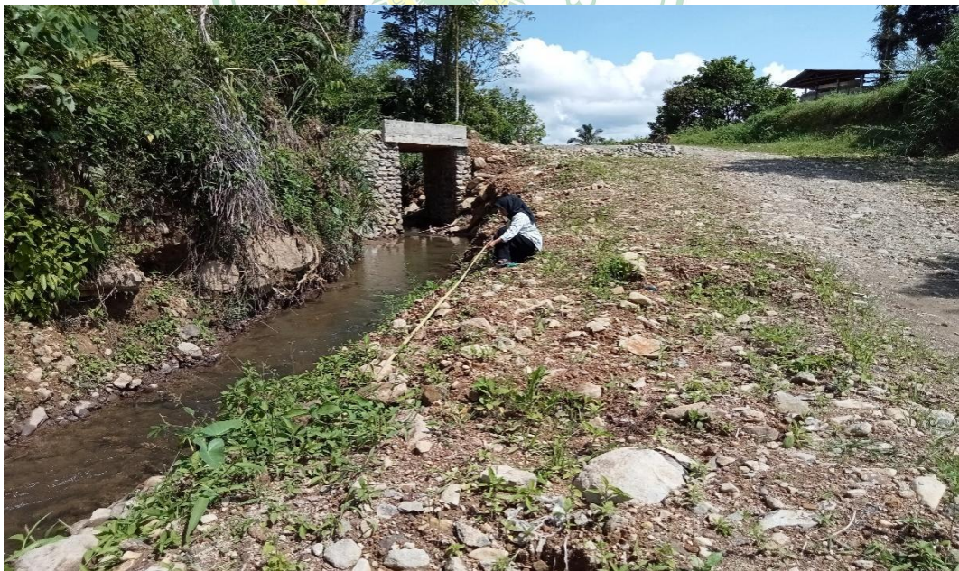
Dokumentasi : Pengukuran kerusakan saluran irigasi
