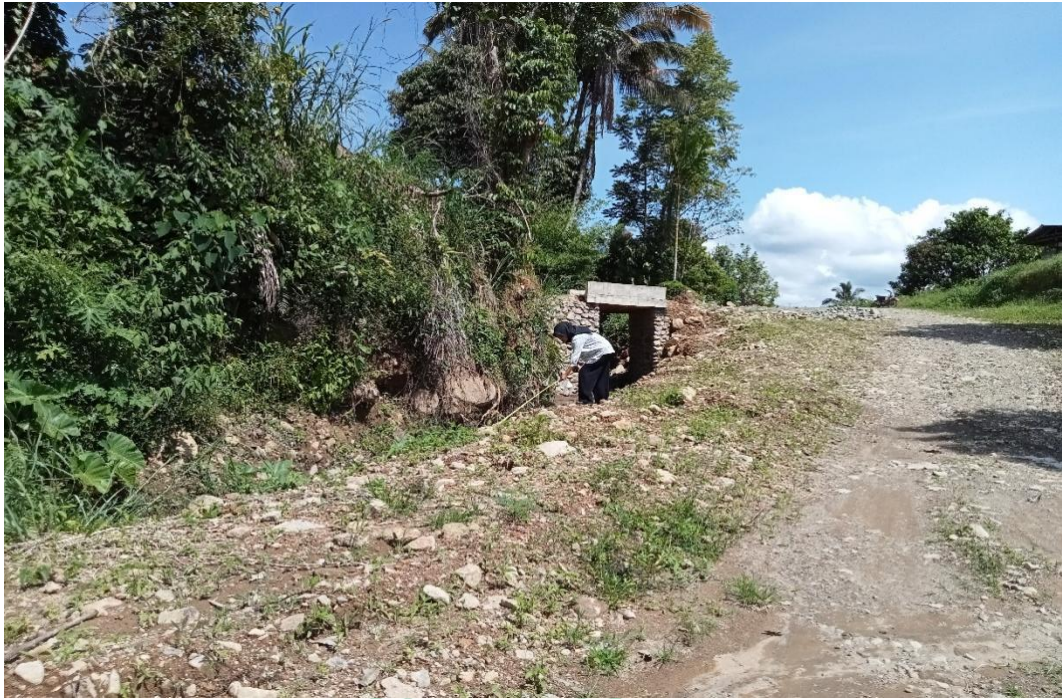
Dokumentasi : Pengukuran kerusakan saluran irigasi
