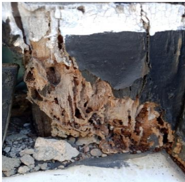
Serangan Rayap Pada Bagian Dinding
