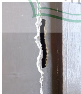
Gambar 10. Jalur Rayap Pada Kusen Jendela
