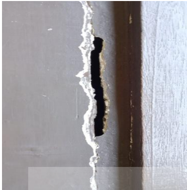
Bekas Serangan Rayap Pada Jendela
