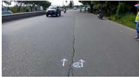
Gambar 2.9 Retak Memanjang ( Longitudinal Cracks )
