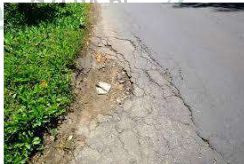
Gambar 2.5 Retak Pinggir ( Edge Crack )
