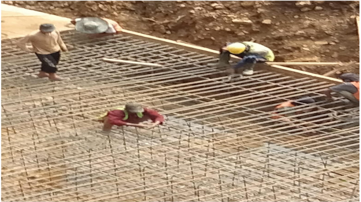
Foto pekerja yang tidak menggunakan APD dengan lengkap.
