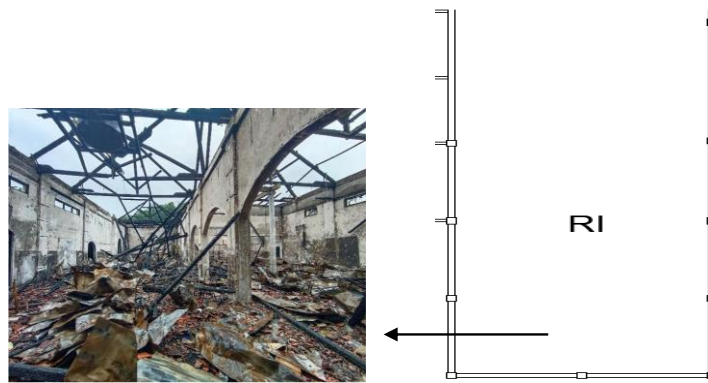
Gambar 4.6 Denah dan kerusakan pelat lantai pada Ruang R1 Sumber : Dokumentasi lapangan
