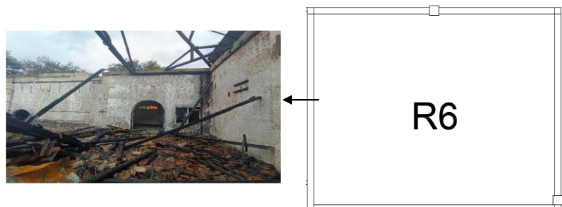
Gambar 4.12 Denah dan kerusakan pelat lantai pada Ruang R6 Sumber : Dokumentasi lapangan
