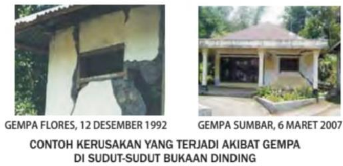
Gambar 2.3 Contoh kerusakan akibat gempa Sumber : (Cipta Karya, 2006)
