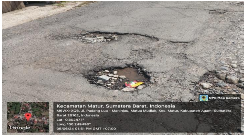
Gambar 4.7. Kerusakan lubang lokasi penelitian Sumber : Dokumentasi survei (2024)
