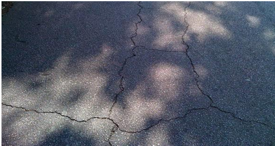
Gambar 2.3. Retak blok Sumber : Hardiyatmo,H.C. (2007)
