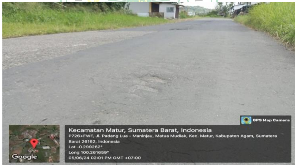
Gambar 4.3. Kerusakan amblas lokasi penelitian
