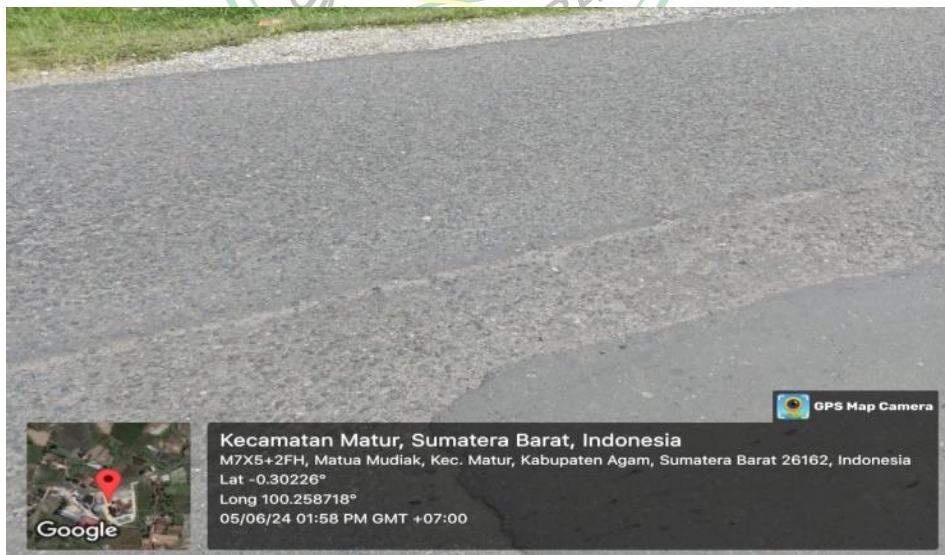
Gambar 4.4. Kerusakan retak memanjang lokasi penelitian Sumber : Dokumentasi survei (2024)
