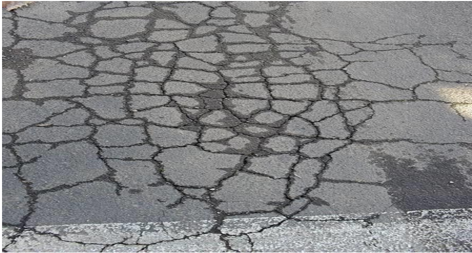
Gambar 2.5. Retak buaya Sumber : Hardiyatmo,H.C. (2007)
