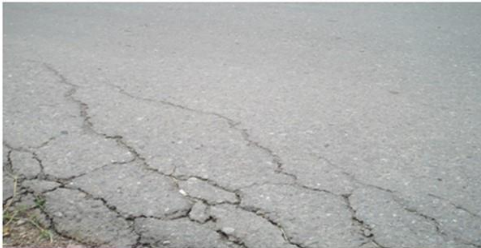
Gambar 2.4. Retak tepi Sumber : Hardiyatmo,H.C. (2007)
