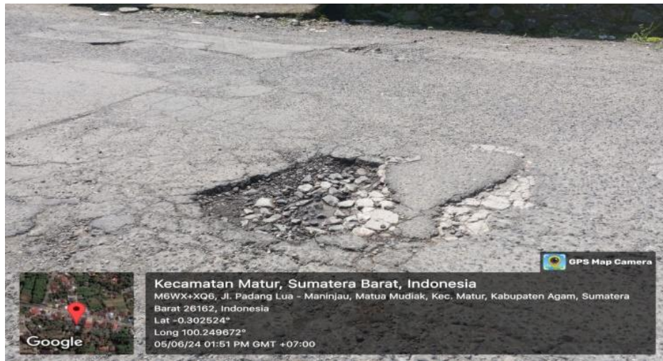
Gambar 4.8. Pengelupasan lapisan permukaan lokasi penelitian Sumber : Dokumentasi survei (2024)
