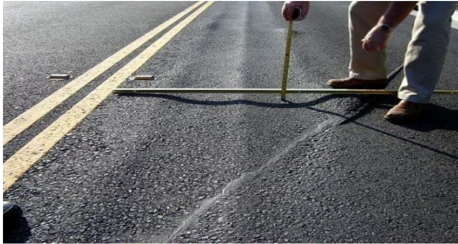
Gambar 2.6. Kerusakan alur Sumber : Hardiyatmo,H.C. (2007)
