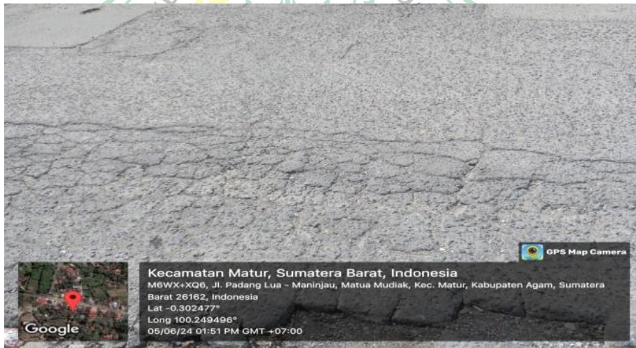
Gambar 4.6. Kerusakan retak acak lokasi penelitian Sumber : Dokumentasi survei (2024)
