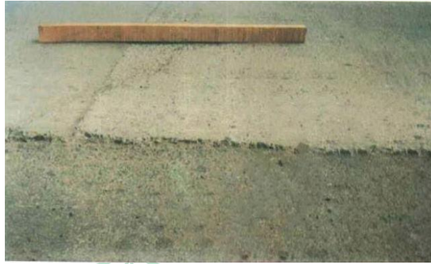
Gambar 2.8 Penurunan pada Bahu Jalan
