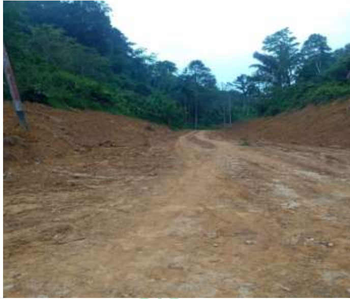
Gambar 3. 2 Kondisi jalan Kampung Baru Sumber : Dokumentasi lapangan (2024)
