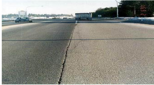
Gambar 2.5 Retak Sambungan Jalan
