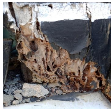
Serangan Rayap Pada Bagian Dinding
