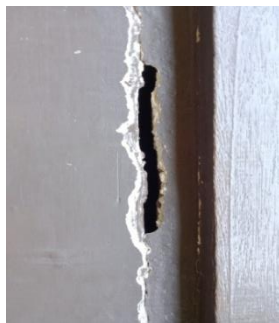
Gambar 10. Jalur Rayap Pada Kusen Jendela
