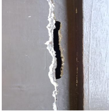
Bekas Serangan Rayap Pada Jendela
