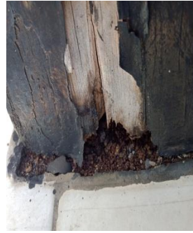
Gambar 13. Bekas Gigitan Rayap Pada Dinding Bangunan
