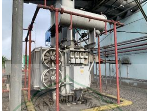
Gambar 2.2. Trafo UAT PLTU Ombilin
