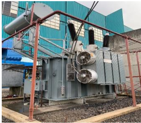
Gambar 2.3. Trafo SST PLTU Ombilin
