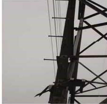
gambar 18 : Step Bolt pada Tower
