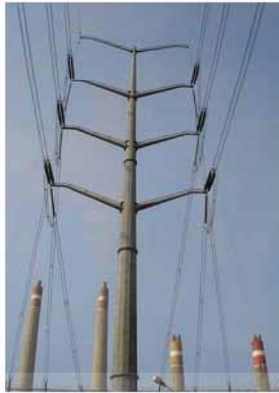
gambar 10 : Tiang Saluran Tubular Steel Pole
