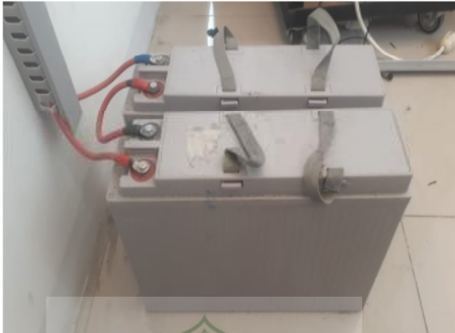
Gambar 4.6 Baterai 100 Ah 12 V 2 buah yang dihubungkan seri
