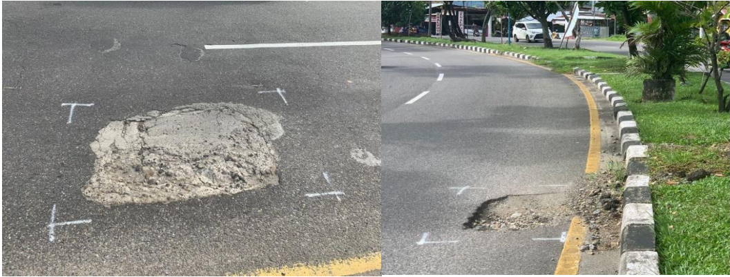
Gambar 4.3 Jalan yang berlubang
