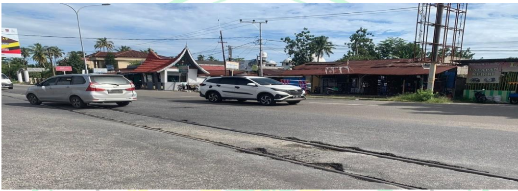
Gambar 4.4 Jalan yang berlubang pada rel perlintasan kereta api
