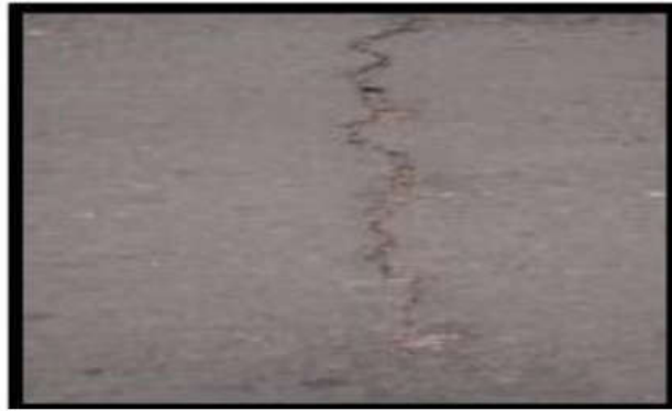
Gambar 2.12 Penurunan Pada Bahu Jalan ( Lane/Shoulder Drop Off )
