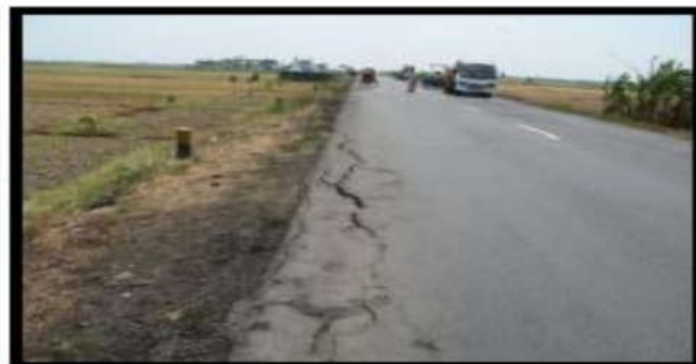
Gambar 2.10 Retak Pinggir ( Edge Cracking )
