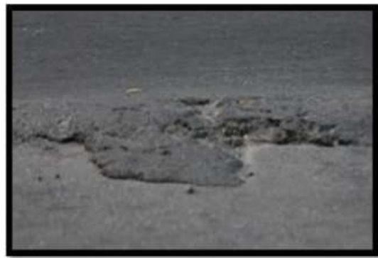
Gambar 2.6 Kegemukan ( Bleeding ) (Sumber : Bina marga no. 03/MN/B/1983 )
