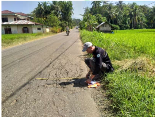
Jalan Lintau – Payakumbuh 37+000 – 37+100 jenis kerusakan : 1. Retak buaya 2. Ambblas
