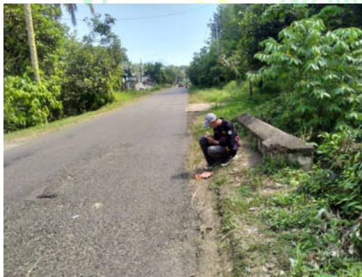
Jalan Lintau – Payakumbuh 37+100 – 37+200 jenis kerusakan : 1. Tambalan
