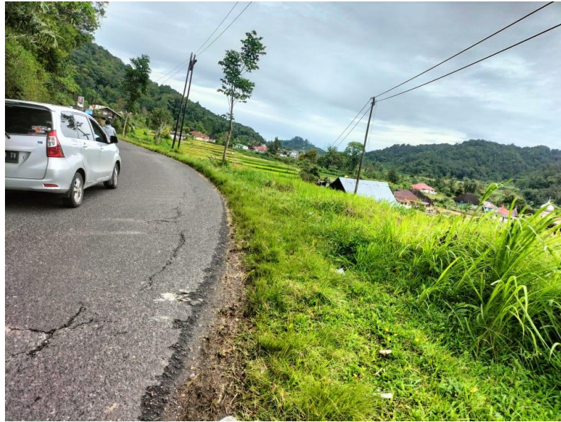
Gambar 4.4 Kondisi bahu jalan
