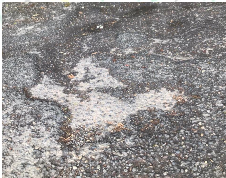
Gambar 4.3 Kondisi jalan yang berlubang
