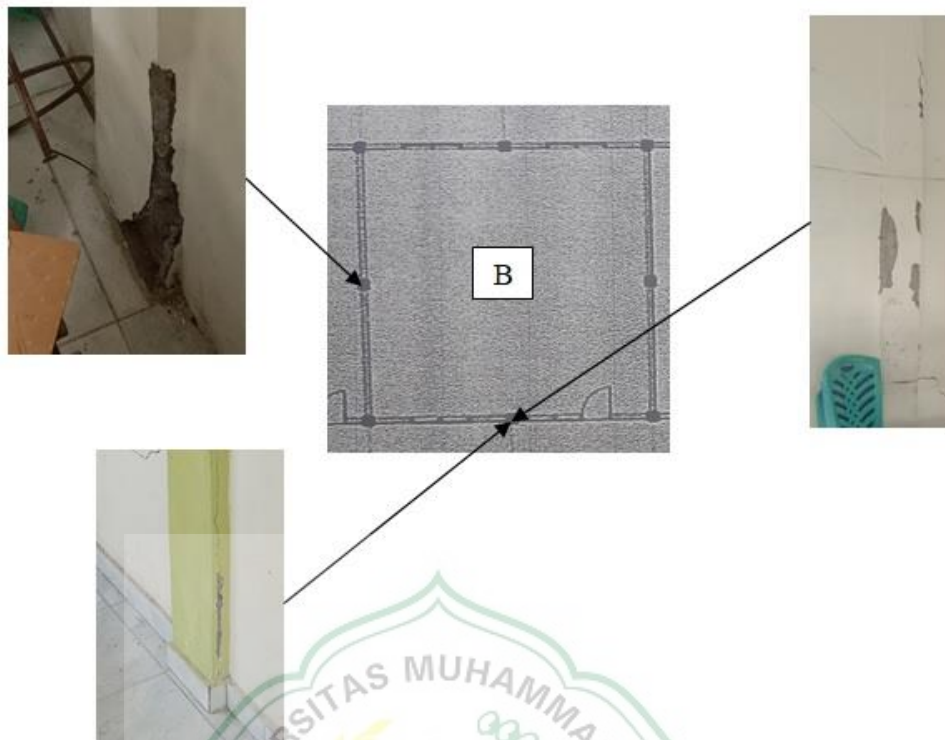
Gambar 4.6. Denah dan kerusakan struktur pada ruangan B
