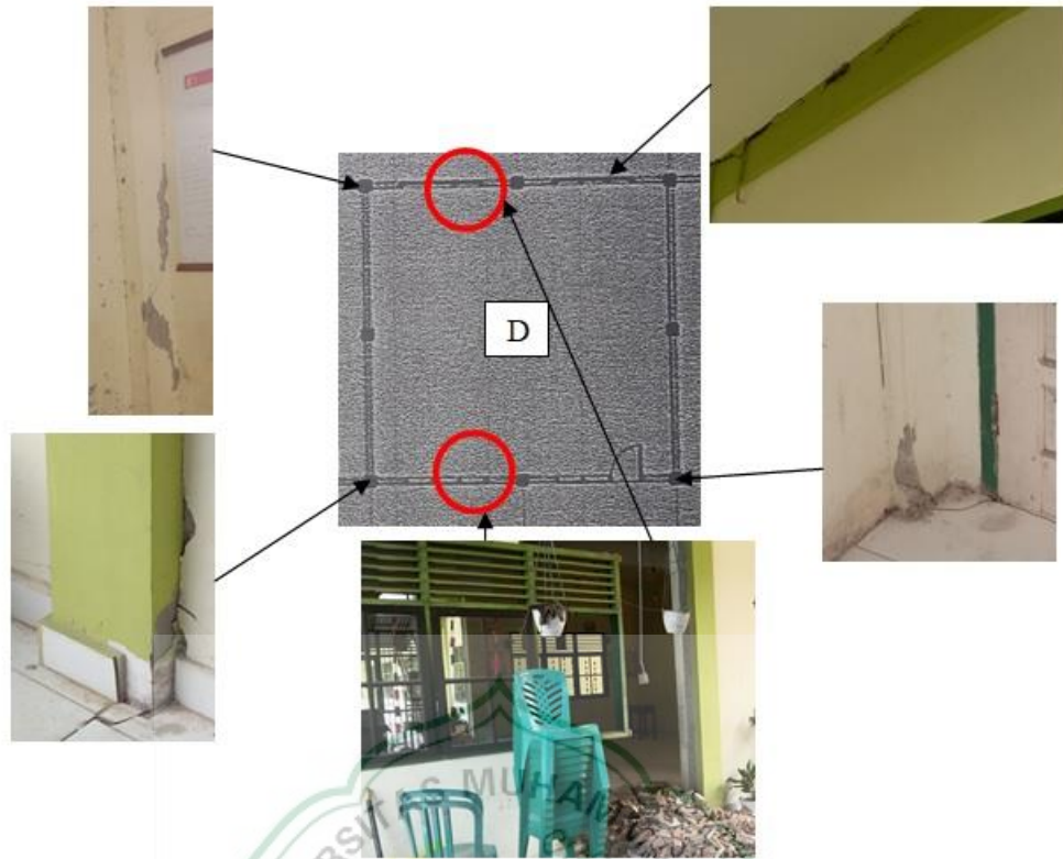
Gambar 4.10. Denah dan kerusakan struktur pada ruangan D
