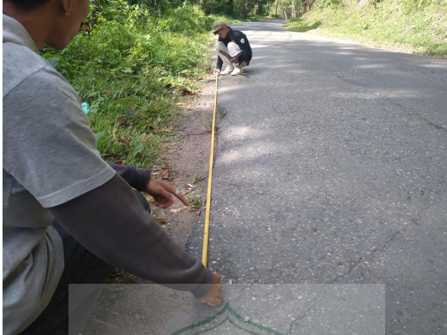
Mengukur Luas Penurunan Bahu Jalan
