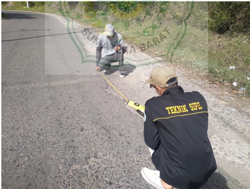
Mengukur Luas cacat tepi perkerasan Jalan
