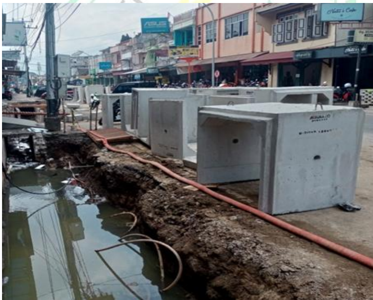
Gambar 2 . Drainase Tipe U- Dicht Jalan A. Yani Kota Payakumbuh Sumber : Dokumentasi Penelitian, 2019
