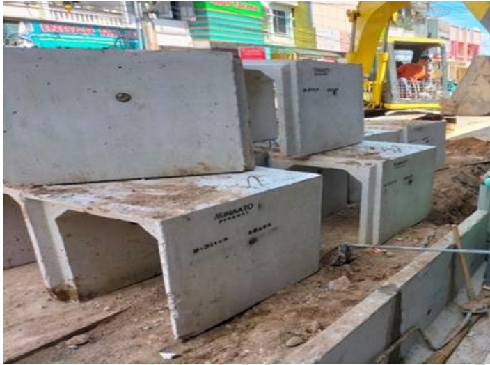
Gambar 1 . Drainase Tipe U- Dicht Jalan A. Yani Kota Payakumbuh Sumber : Dokumentasi Penelitian, 2019
