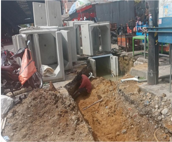
Gambar 3 . Drainase Tipe U- Ditch Jalan A. Yani Kota Payakumbuh Sumber : Dokumentasi Penelitian, 2019
