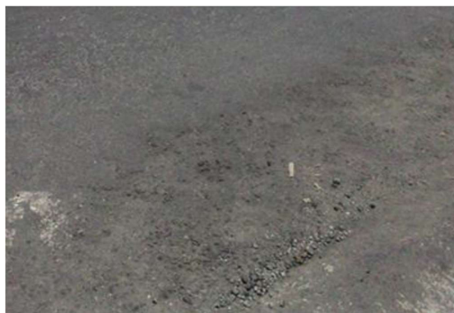
Gambar 2.14 Kerusakan Jalan Pelepasan Butir
