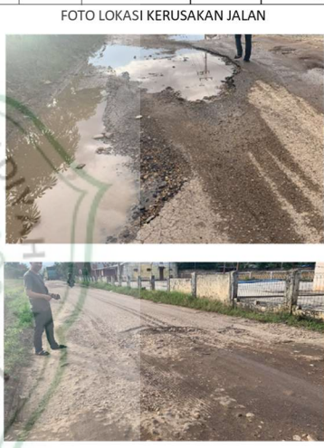
Gambar 4.5 Formulir Kerusakan Jalan Metode PCI Segmen 2
