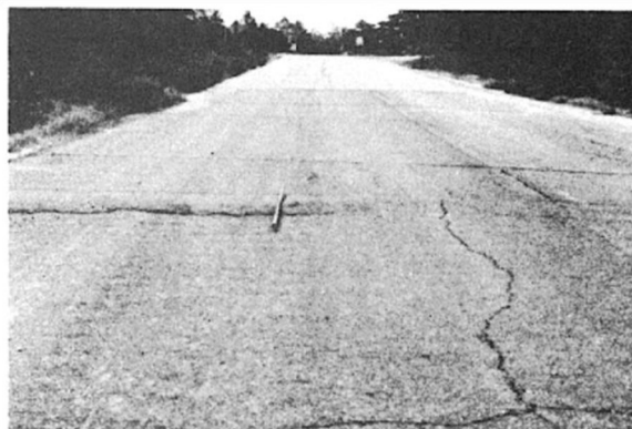
Gambar 2.13 Kerusakan Jalan Cekungan (Bumb and Sags)
