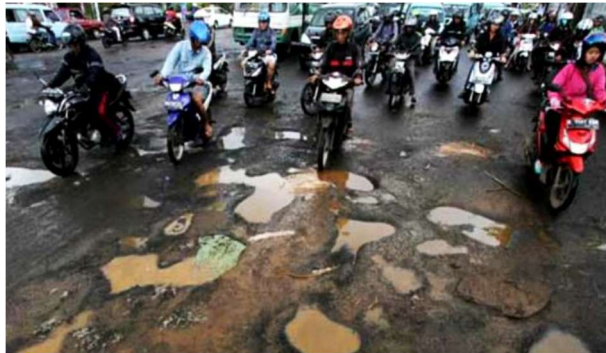
Gambar 2.12 Kerusakan Jalan Photoles
