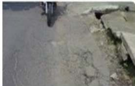
Gambar 2.13 Jalan Rusak Amblas Sumber : Widana Putra, 2009
