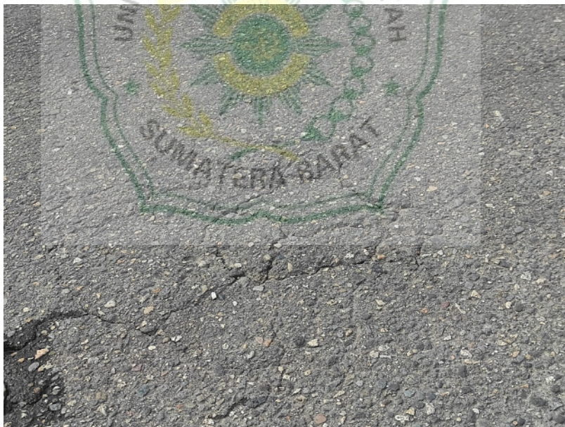
(Dokumentasi Retak Kulit Buaya)
