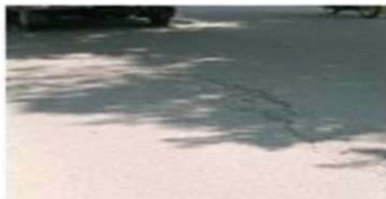
Gambar 2.6 Retak Sambung Jalan.
