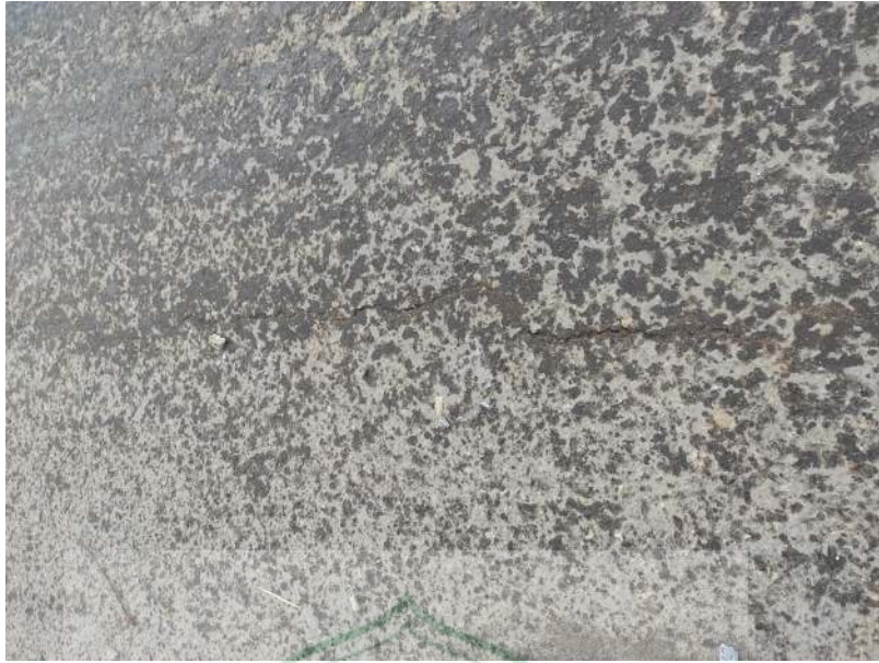
(Dokumentasi Retak Pinggir)
