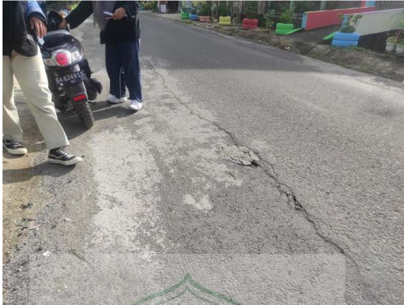
(Dokumentasi Retak Pinggir)
