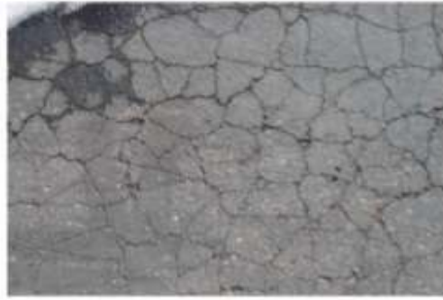
Gambar 2.4 Retakan Kulit Buaya
