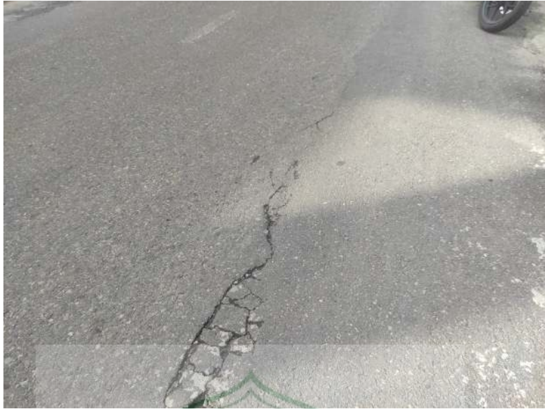
(Dokumentasi Retak Pinggir)
