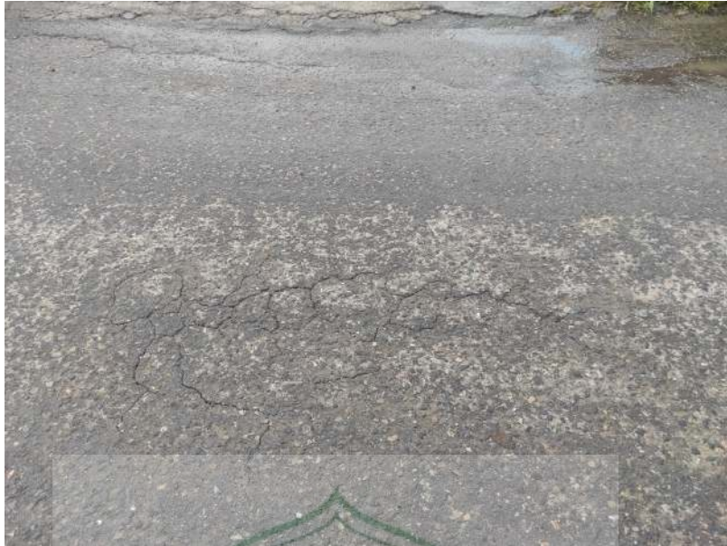
(Dokumentasi Retak Kulit Buaya)
