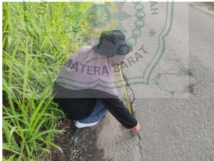
(Dokumentasi Retak Pinggir)
