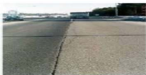
Gambar 2.7 Retak Sambungan Pelebaran Jalan
