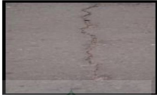
Gambar 2.12 Penurunan Pada Bahu Jalan ( Lane/Shoulder Drop Off ) (Sumber : Bina marga no. 03/MN/B/1983)
