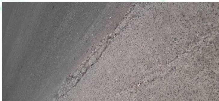
Gambar 4.5. Jalan yang berlubang dan bahu jalan yang rusak
