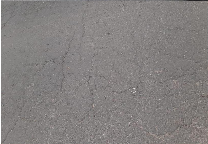
Lampiran 2 Foto kerusakan jalan bahu jalan
