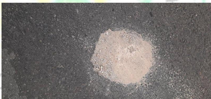
Gambar 4.4. Jalan yang berlubang
