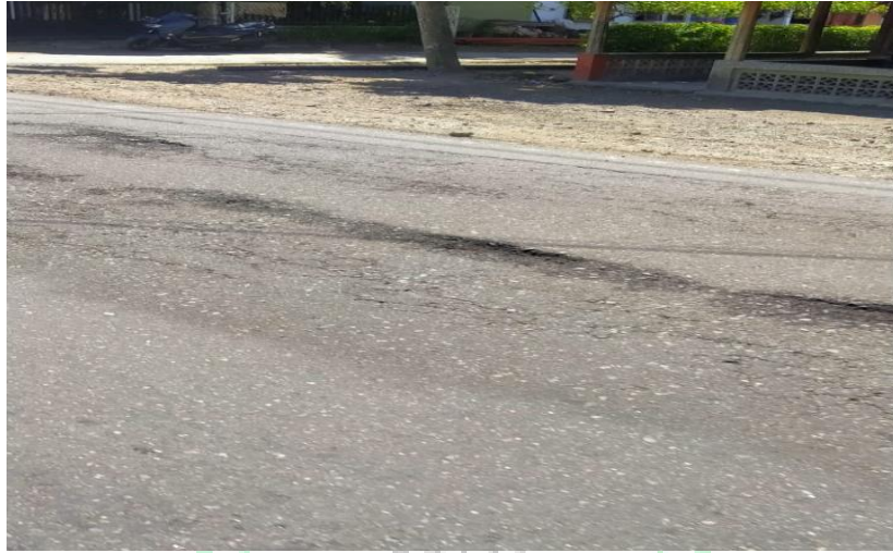
Gambar 4.3. Jalan yang berlubang. Sumber: Dokumentasi (2022).
