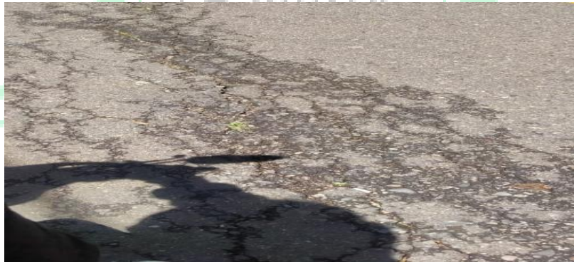
Gambar 3.3. Retakan pada badan jalan.
