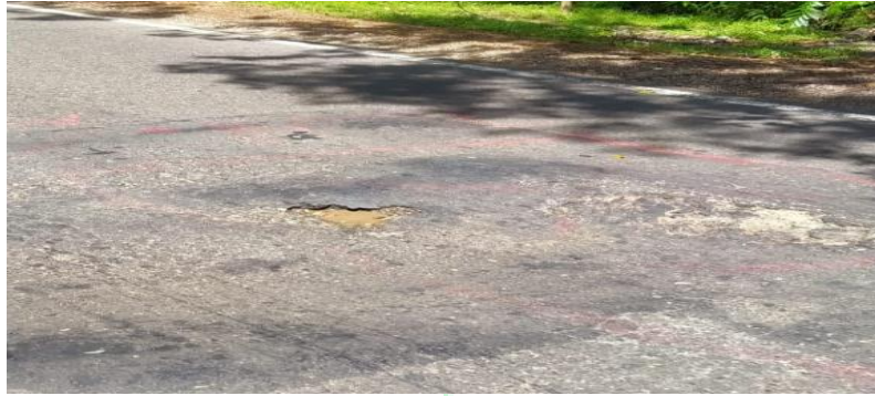
Gambar 3.2. Jalan yang berlubang.
