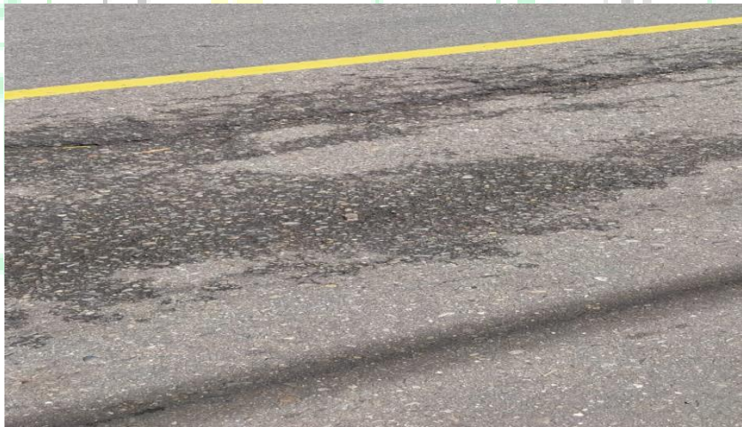
Gambar 4.4. Retak pada jalan. Sumber: Dokumentasi (2022).
