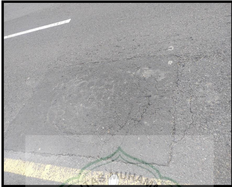
Foto 7. Kerusakan Jalan Tambalan Dokumentasi : Syamsuwirman, 20 Juli 2021, Jalan Raya Kubu Karambia-Pasar Pitalah
