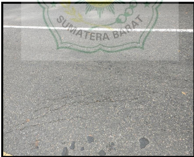
Foto 8. Kerusakan Jalan Retak Kulit Buaya Dokumentasi : Syamsuwirman, 20 Juli 2021, Jalan Raya Kubu Karambia-Pasar Pitalah
