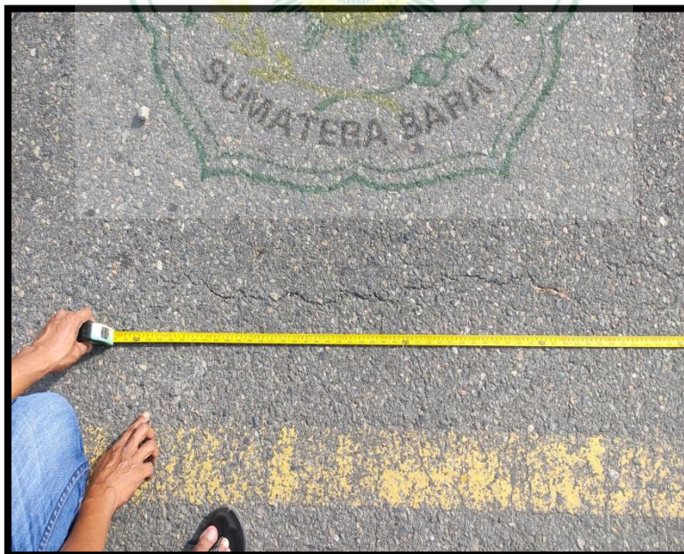
Foto 6. Pengukuran Kerusakanan menggunakan meteran Dokumentasi : Syamsuwirman, 20 Juli 2021, Jalan Raya Kubu Karambia-Pasar Pitalah
